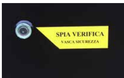
Spia verifica vasca sicurezza
